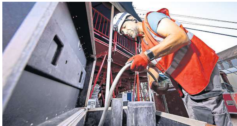
Toni Munar rollt meterweise Kabel ein, das für die viele Technik während der Show gebraucht wurde, und verstaute es in Kästen.
