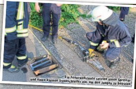
Die Feuerwehrleute setzen einen Sprinkler und Open-Kolben-Trennschleifer ein, um den jungen zu befreien
